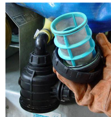
FILTROS Estado y limpieza de la malla
