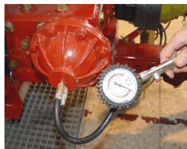
BOMBA Medida de la presión interna del calderín
